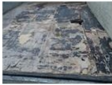
Door R R, Rust, Le - Replace and paint
