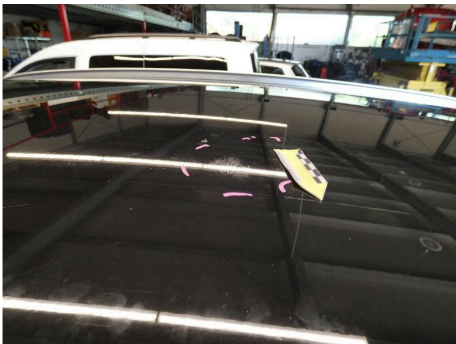
Bild 24 Dach Dachhaut verätzt
