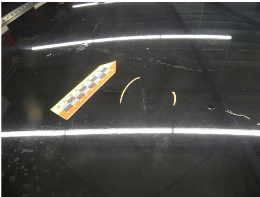
Bild 47 Dach Dachhaut verformt + verkratzt
