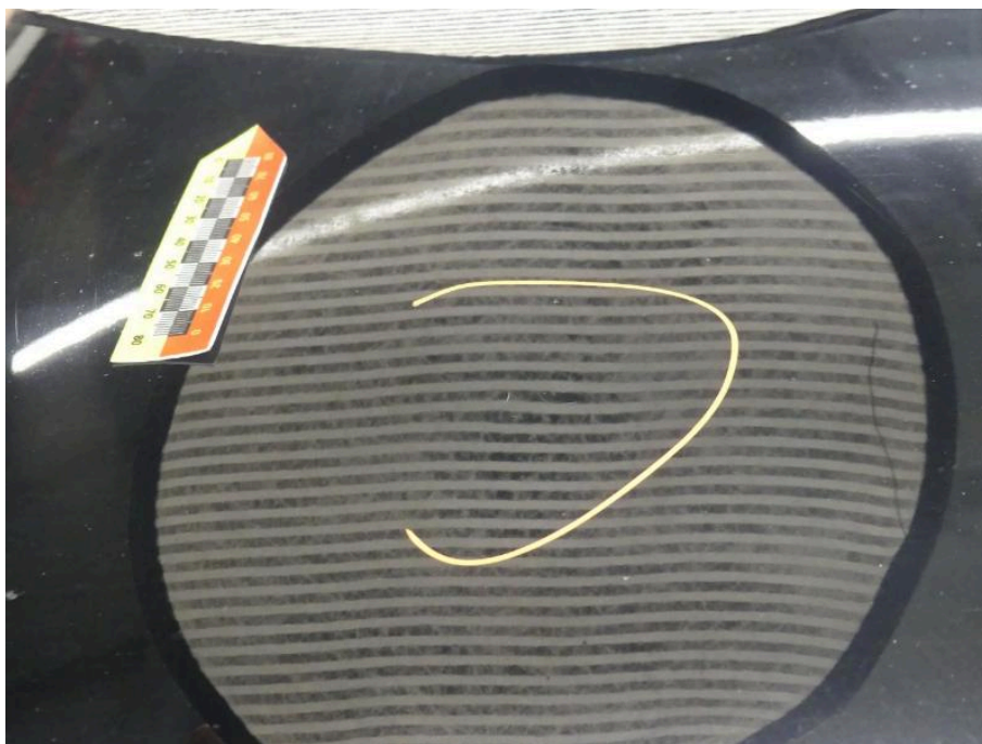
Bild 48 Dach Dachhaut verformt + verkratzt
