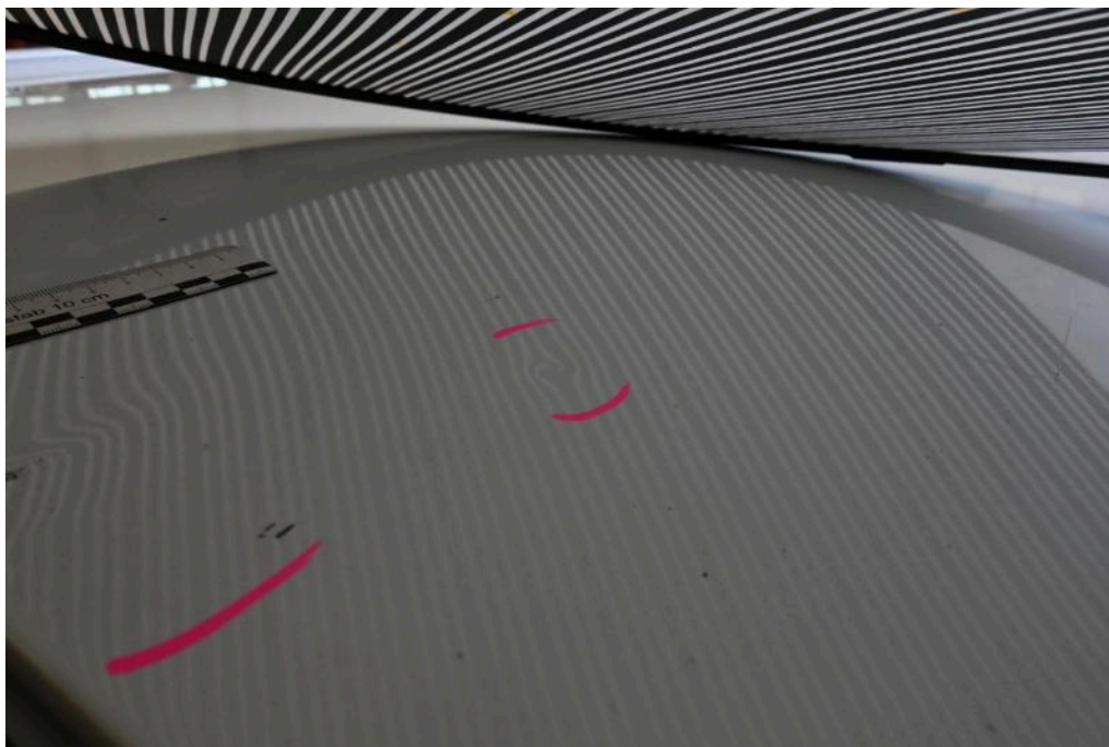
Bild 23 Dach Dachhaut mit Lackbeschädigung Dellen
