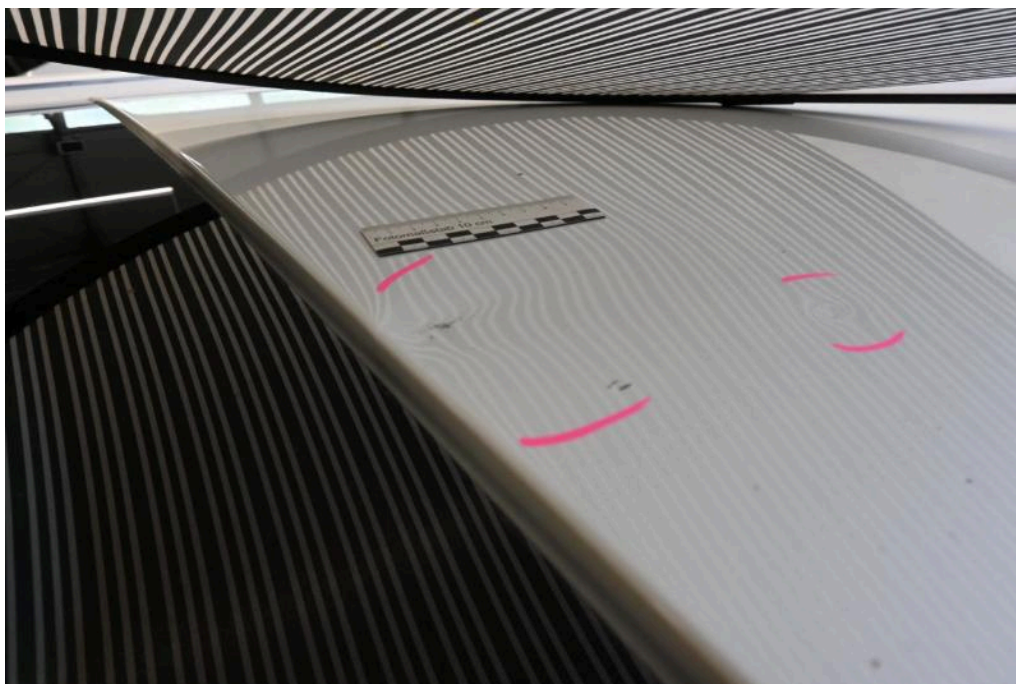
Bild 22 Dach Dachhaut mit Lackbeschädigung Dellen
