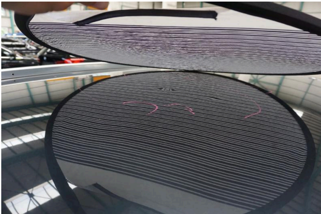
Bild 24 Dach Dachhaut verformt, verbeult Dellen
