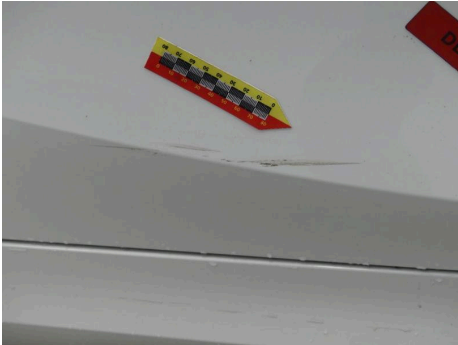
Bild 45 rechte Seite Tür hinten rechts Tür HR instandsetzen / Tür VR erneuern beschädigt
