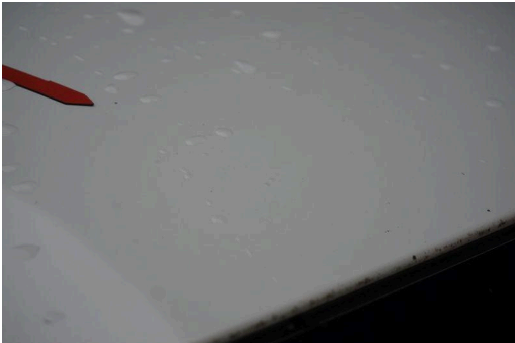
Bild 52 Dach Dachhaut vorn Steinschlag / -schläge
