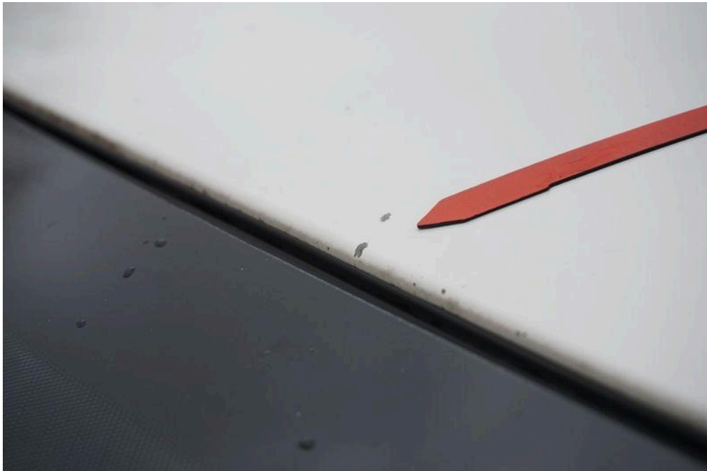
Bild 50 Dach Dachhaut vorn Steinschlag / -schläge
