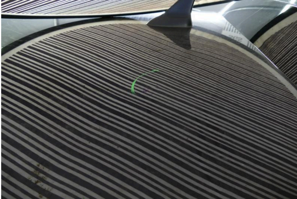
Bild 43 Dach Dachhaut Dellen/Vogelkotanhaftungen/Steinschlag
