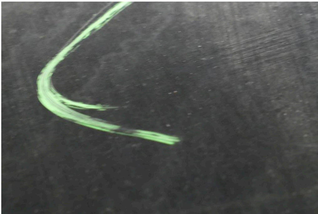
Bild 46 Dach Dachhaut Dellen/Vogelkotanhaftungen/Steinschlag
